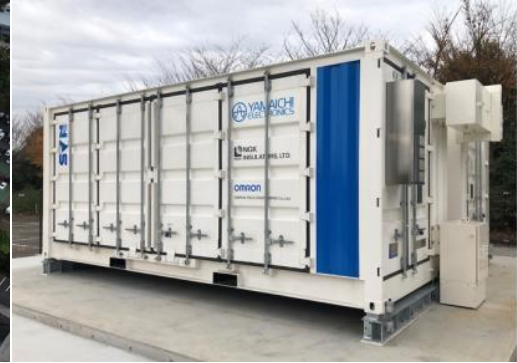
非常時の電源確保に使われる大型蓄電池 太陽光発電の使い切れない電力を充電
