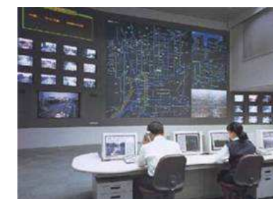
交通/道路管理システム
